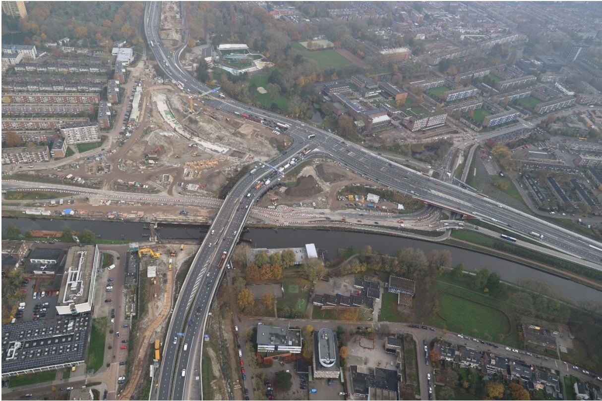
De eerste boog vol beton wordt al duidelijk zichtbaar op het Julianaplein; dit is de bocht die het meest diep ligt en loopt van Hoogezand richting Assen.
