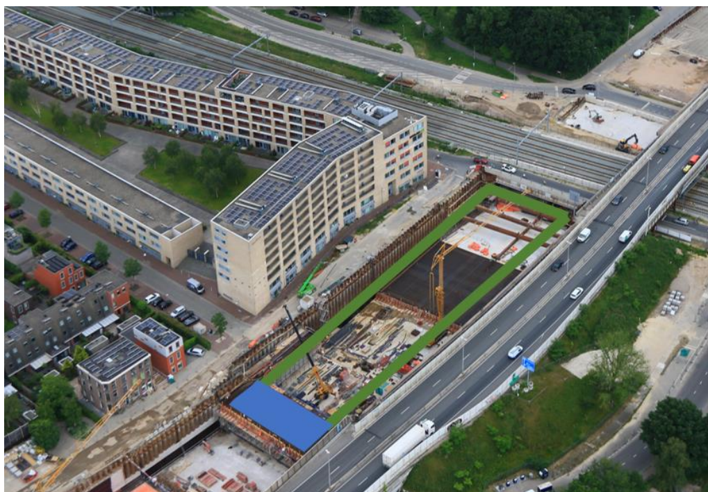
De groene lijn is de opening in de verdiepte ligging. Het blauwe vlak is het techniekgebouw.
