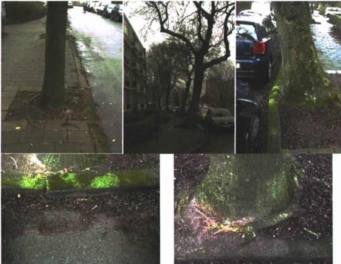
Bovengrondse beelden van ontbreken beworteling in asfalt rijbaan, nummering foto's 1 tot en met 5 (vanaf linksboven met de klok mee)
